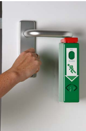
Berechtigte Personen benutzen nicht die Klinke, sondern öffnen die Tür mit dem Schlüssel, um einen Alarm zu umgehen.
